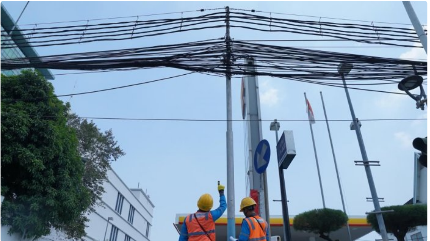
Photo: Titik Lokasi pencuri Kabel PLN
